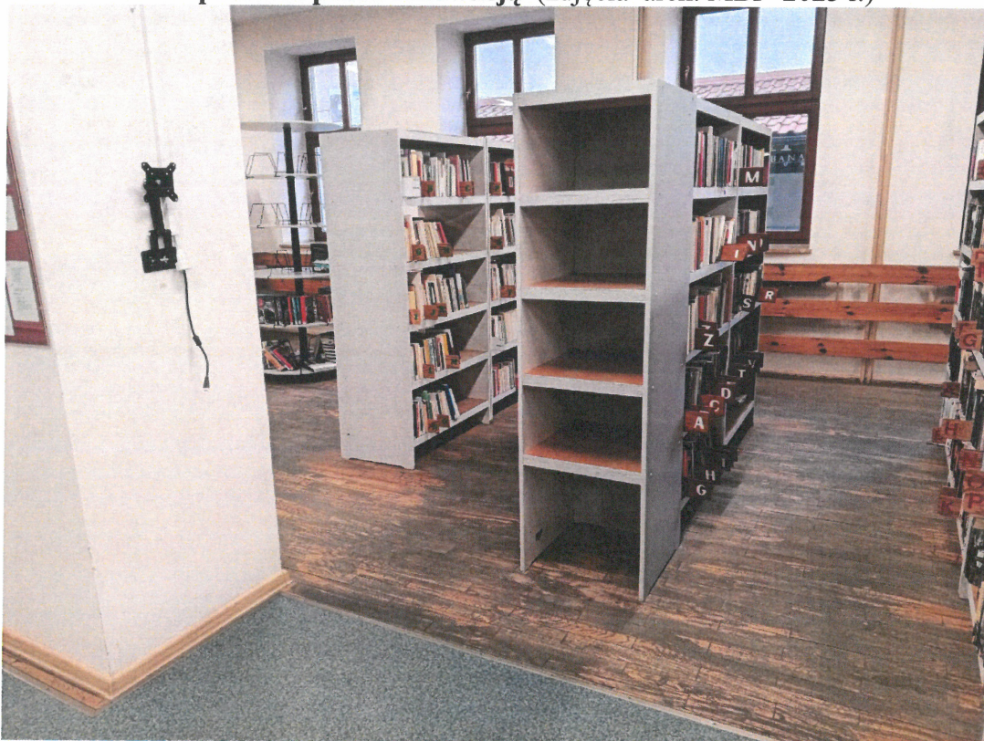
Stan parkietu przed renowacją (zdjęcia arch. MBP 2023 r.)
